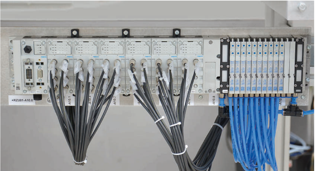
Isleta de válvulas con módulo de entrada y salida
