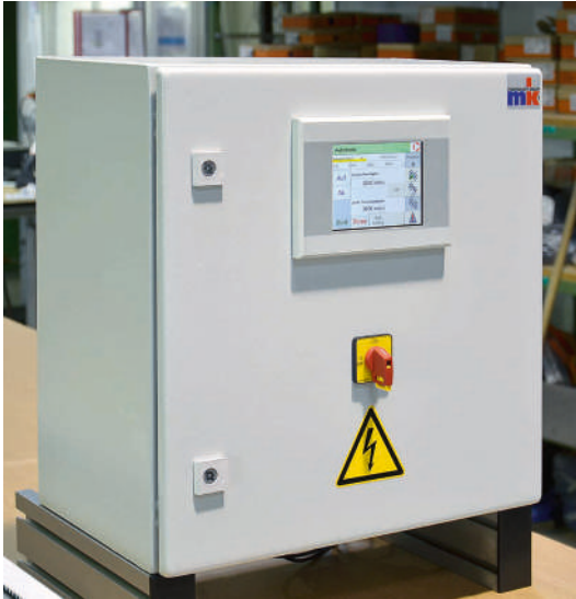
Armario de mando con panel de mando en el que se pueden realizar directamente pequeñas modificaciones en el programa
